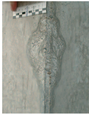
Gebrochene Kante, Breite ca. 10 mm mit Ausblutungen bis ca. 50 mm Breite, Haus der Baustoffindustrie, Ostfildern
