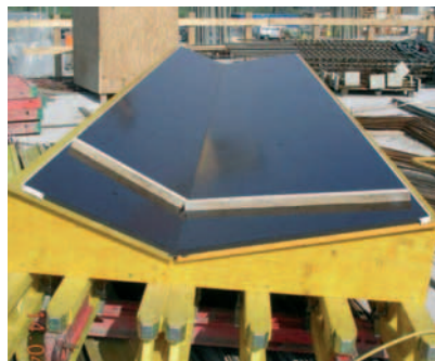
Schaltafelstoß im stumpfen Winkel, abgedichtet mit Fugeneinlage. Schalhaut verwendungssteif auf Trägerkonstruktion (Peri). Mercedes-Benz Museum Stuttgart
