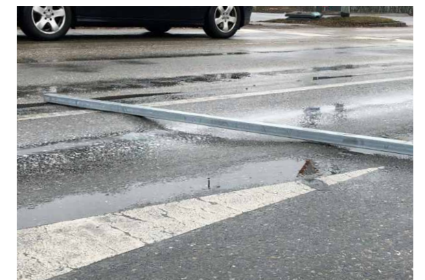
Verdrückungen im Asphalt aus Überlast durch Bremsen, Halten, Anfahren
